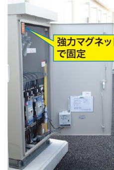
●使用例(キュービクル点検作業)
